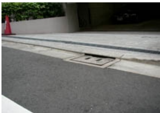
(a) 街角の段差
